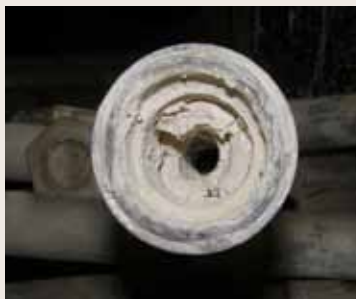
Zarostlé potrubí kalem ze Zn fosfátování
